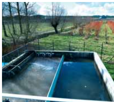
► La station d'épuration d'Ecquedecques.
